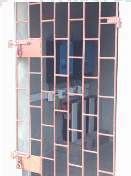
Figure 5: Protection des onduleurs - Source : Cogesten@2022
