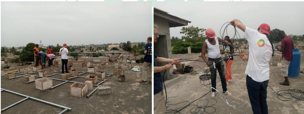
Figure 2: Mise en place des équipements nécessaires à l'installation des panneaux solaires Source : Cogesten@2022
